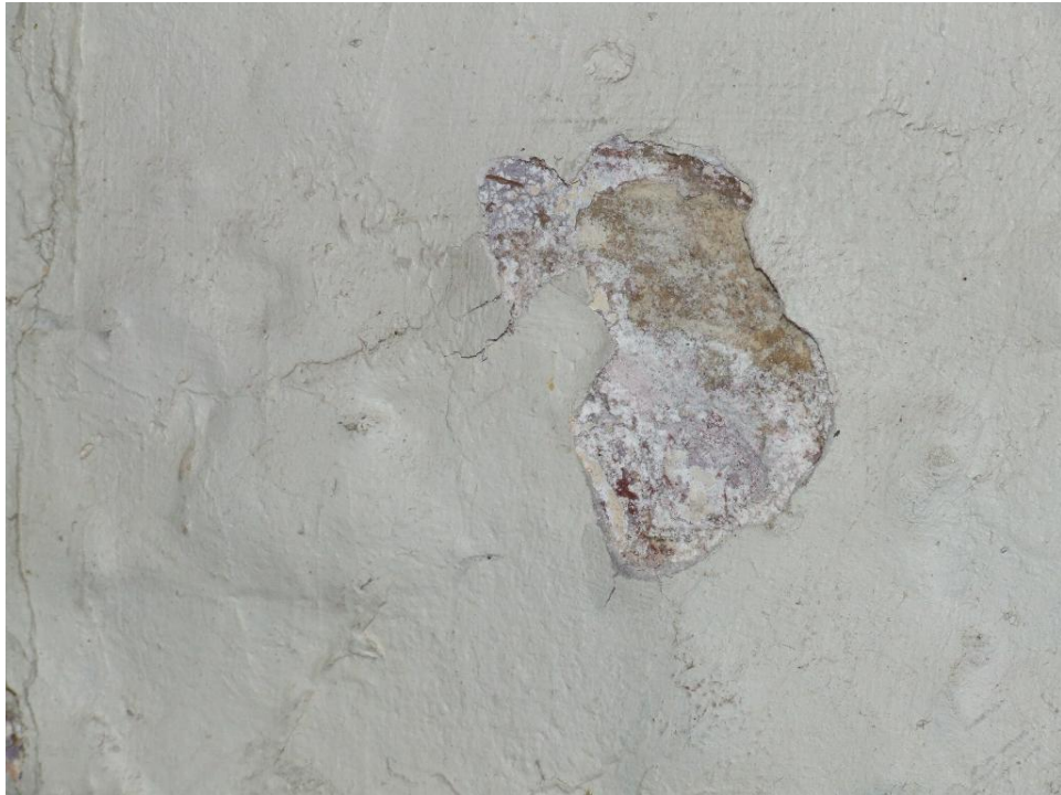
Bild 6, Putzablösung durch Salze
